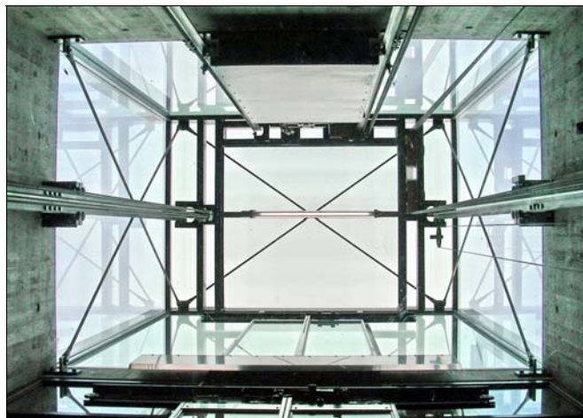
Personen- und Lastenaufzüge
